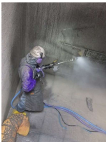
沖縄県北谷浄水場耐震工事 テックサービス(株) (株)ゲーテック
