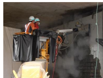
橋梁橋台補修工事(福島県) 劣化部除去(ハツリ工) 2018年4月 (株)ネクスコ・メンテナンス東北
